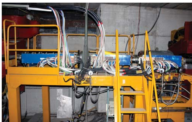
Рис. 3.2.2.3. Вид 34-го промежутка с смонтированными выводными элементами. Слева – септум магнит СМ-34, в центре и справа С-образные магниты ОМ1 и ОМ2.
