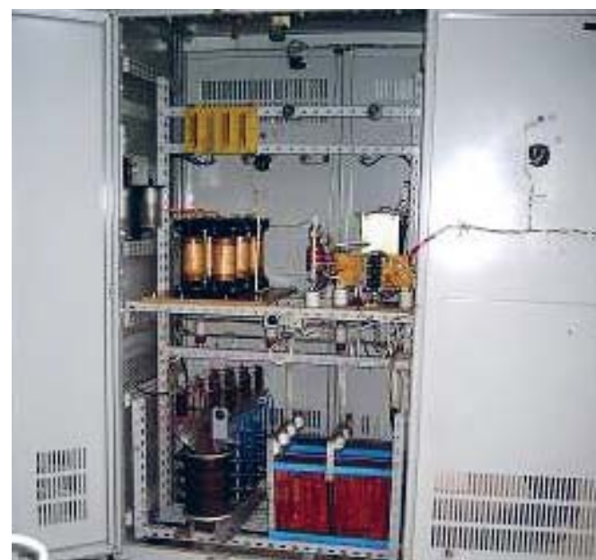
Рис. 2.5.2. Общий вид силового шкафа питания септум-магнита
