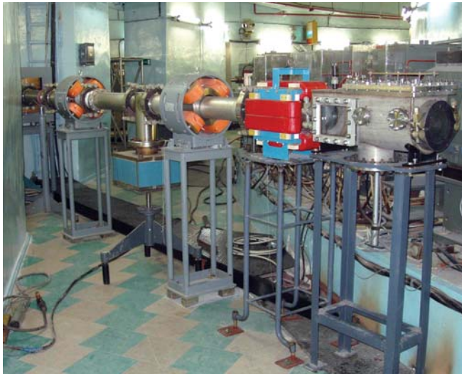
Рис. 2.4.6. Завершающая часть канала перевода (перед вводом пучка в У-1,5)
